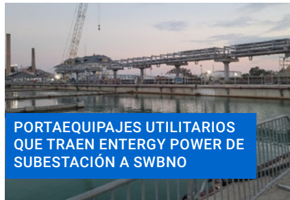
SUBESTACIÓN DE ENTERGY
